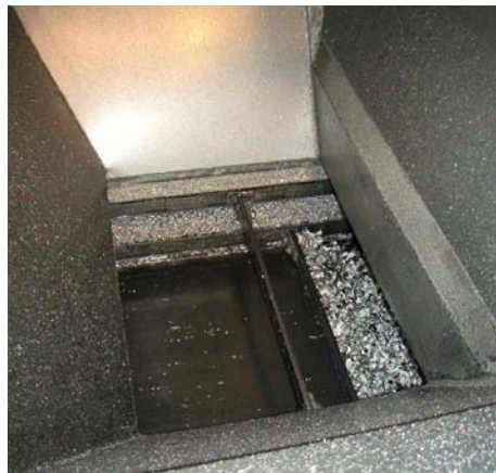
Bild 32 Späneförderer als Absaugstelle
