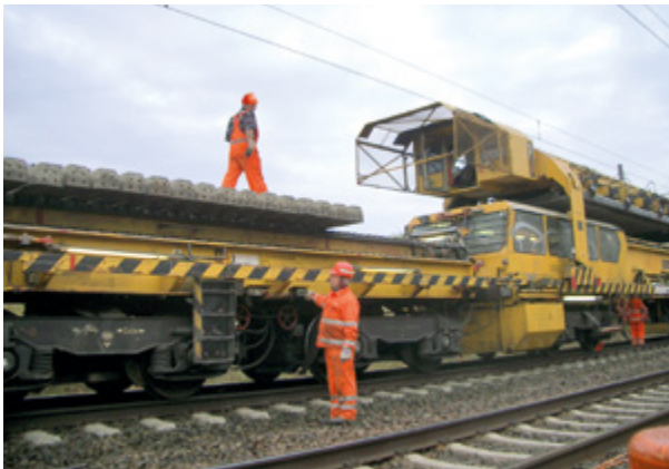
Abb. 8-8: Bei Arbeiten auf dem Umbauzug muss die Oberleitung ausgeschaltet und bahngeerdet sein.
