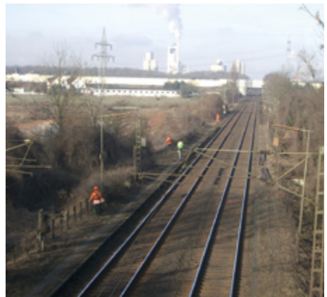
Abb. 12-22: Vegetationspflege mit Freischneidern: da die Beschäftigten sich längs des Gleises weit verteilt haben, ist eine Sicherung mit Absperreposten nicht möglich. Die Wahrnehmbarkeit der akustischen Warnsignale muss gewährleistet sein.
