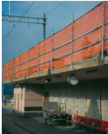
Abb. 4-9: Die Abschrankung für Arbeiten auf einem Bahnsteigdach neben einer Oberleitung soll die Gefahr ausschließen, den Schutzabstand zur Oberleitung unbeabsichtigt zu unterschreiten.
