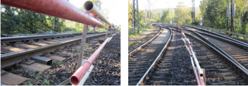
Abb. 2-8: Geeignete Feste Absperungen können auch im Bereich von Weichenzungen montiert werden (links). Unterbrechungen der Feste Absperungen in Weichenbereichen werden mit sichtbarer Abgrenzung kenntlich gemacht und während der Arbeiten z. B. mit Absperrosten gesichert (rechts).
