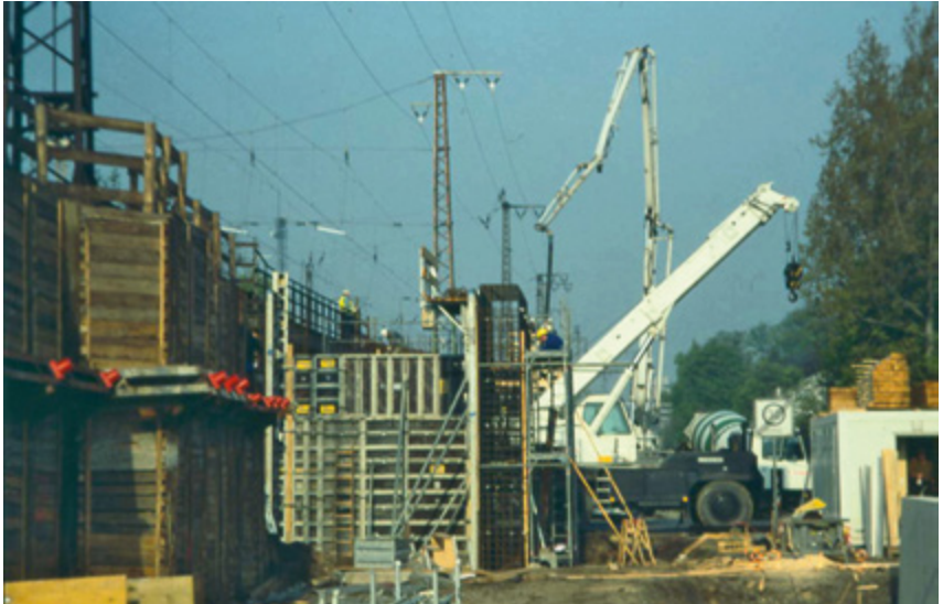
Abb. 1-2: Bei Mobilkran und Betonpumpe besteht hier die Gefahr der Annäherung an die auf den Fahrleitungsmasten geführte Speiseleitung.
