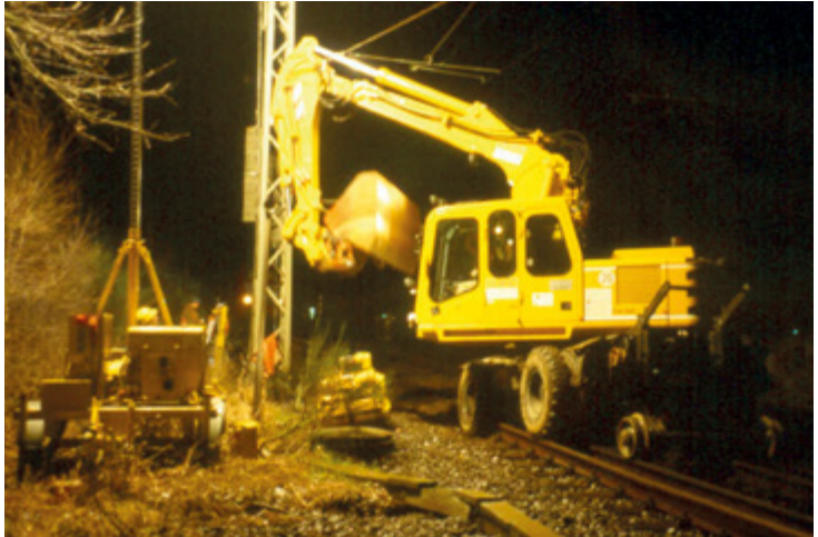
Abb. 7-23: Beim Verlassen der Schienen geht die Bahnerdung verloren.
