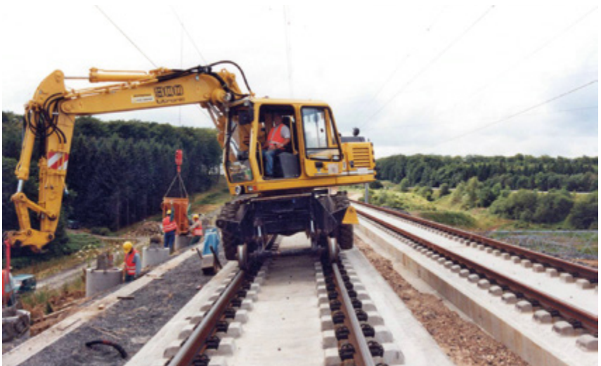
Abb. 7-10: Auf dem Gleisfahrwerk liegt die Kippkante des Baggers wesentlich weiter innen als auf dem Straßenfahrwerk. Die Gleisüberhöhung im Bogen verringert die Standsicherheit.
