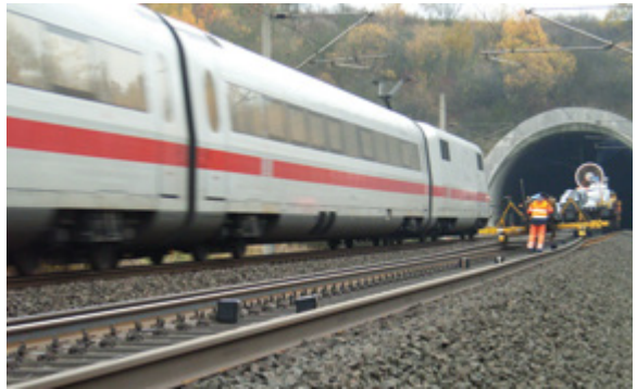
Abb. 11-1: Schienenwechsel im Tunnel bei ortsfest aufgestellter (oben) und mobil mitgeführter (rechts) technischer Lüftung.
