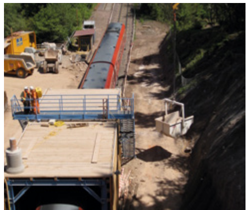
Abb. 12-11: Schwenken eines Krans über ein nicht gesperrtes Gleis: Schutzgerüst erforderlich.
