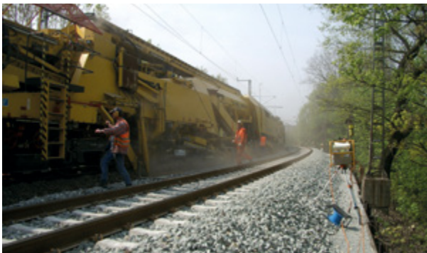
Abb. 8-1: Arbeitsplätze auf der Mittelkernseite einer Planumsverbesserungsmaschine.
