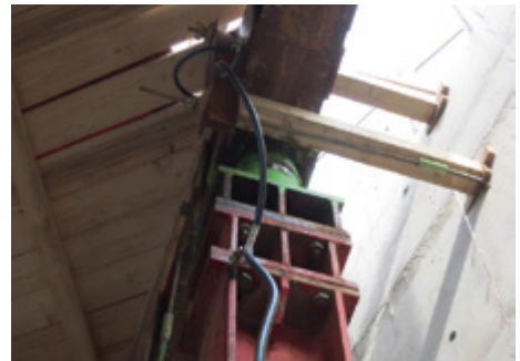
Abb. 12-18: Verbindung zur Bahnerdung am Jochträger und an den Stützen des Traggerüsts.
