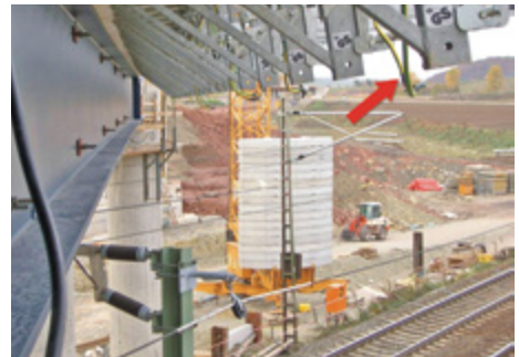
Abb. 12-19: Verbindung zur Bahnerdung am Traggerüst an den Trägern der Kappenschalung.
