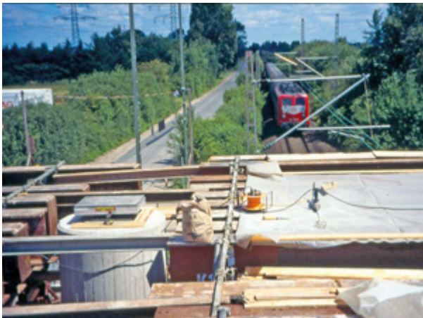
Abb. 12-16: Die Arbeiten auf der Trägerlage sind nicht zulässig, da Gefahr besteht, dass Baumaterial in das Betriebsgleis fällt oder die Fahrleitung mit händisch bewegtem Material erreicht wird.
