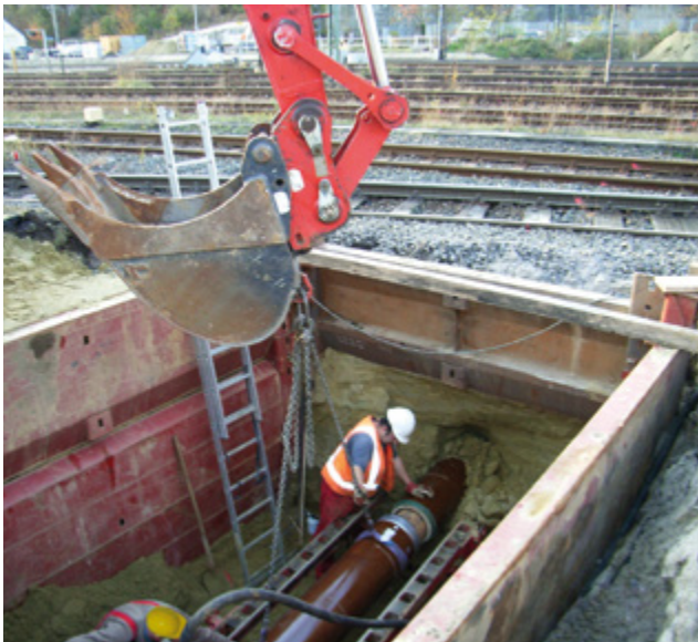
Abb. 12-7: Rohrvortrieb unter einer Gleisanlage: Eine feste Abspernung wäre erforderlich, um das unbeabsichtigte Hineingeraten in den Gleisbereich zu verhindern und die Grenze des Arbeitsbereichs zu kennzeichnen. Der Stirnverbau muss ergänzt werden.
