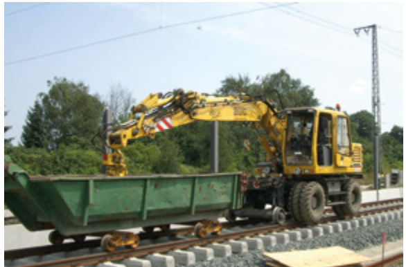
Abb. 7-18: Unzulässiger Einsatz eines Zweiwegebaggers zum Bewegen eines Containers auf Schienenfahrwerken. Container auf Schienenfahrwerken sind u. a. wegen Gefahren durch unkontrolliertes Abrollen, fehlende Standsicherheit auch im Baugleis nicht zugelassen.
