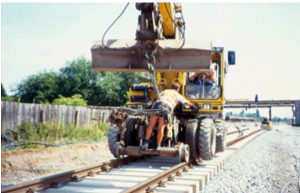
Abb. 7-9: Unzulässige Mitnahme eines Beschäftigten auf der Schienenachse des Zweiwegebaggers.
