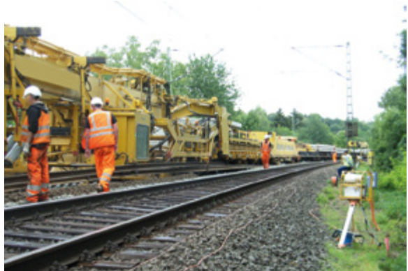
Abb. 8-2: Automatisches Warnsystem für die Warnung der Beschäftigten (Zentrale der feldseitigen Warnanlage steuert Maschinenwarnanlage des Umbauzuges an).
