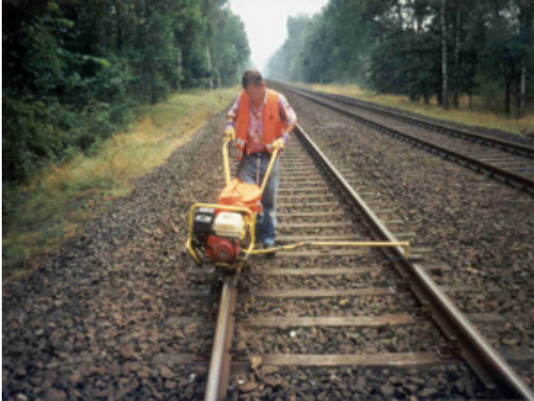
Abb. 6-1: Bei Arbeiten mit Maschinen, z. B. Schraubmaschinen, muss das Arbeitsgleis gesperrt sein. Warnwesten sind geschlossen zu tragen.
