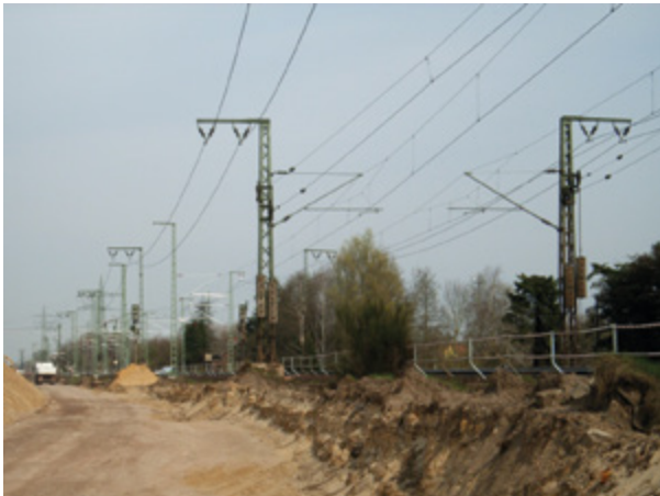
Abb. 4-1: Oberleitungsanlage mit Abspannungen sowie Speiseleitung auf den Oberleitungs- masten.
