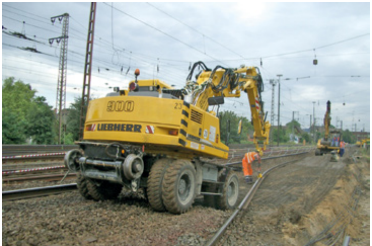
Abb. 7-24: Bei unebenem Gelände kann der Schutzabstand zur Fahrleitung unterschritten werden. Warnkleidung ist geschlossen zu tragen.
