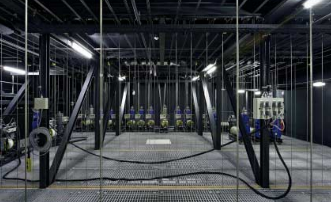
Bild 11: Maschinentechnische Einrichtungen der Obermaschinerie
