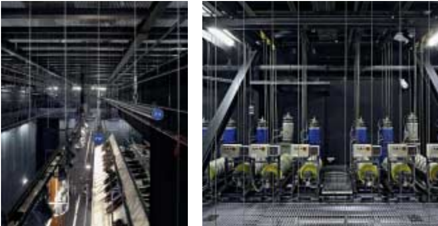
Bild 1 und 2: Maschinentechnische Einrichtungen der Obermaschinerie
