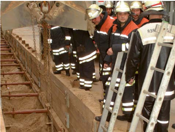
Leitern ermöglichen einen sicheren Zugang.
