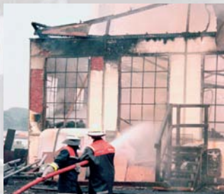
Einsturzgefahr der Fassade durch Brandeinwirkung
