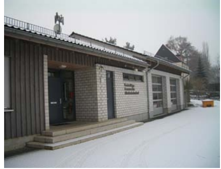
Treppen als Zugang zu Feuerwehrhäusern sind immer Gefahrstellen – auch wenn sie den baurechtlichen Anforderungen genügen.
