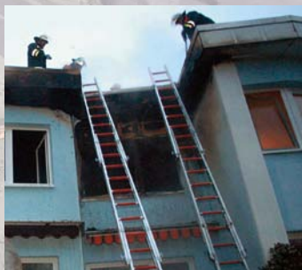
Absturzgefahr! Brandbekämpfung auf dem Flachdach
