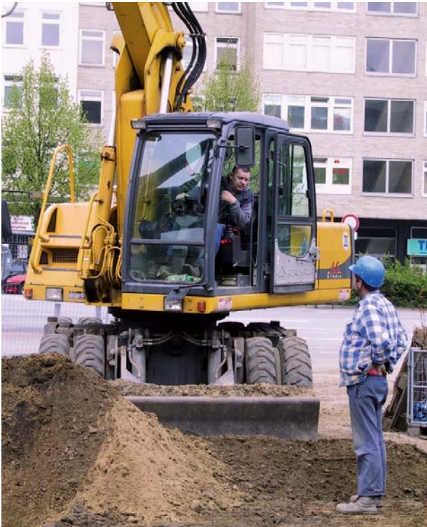
Der herangeführte Bagger kann gefährliche Erschütterungen verursachen.
