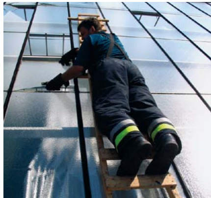
Beschädigte Glasscheiben eines Gewächshauses werden nach Beschädigung durch Hagelschlag vorsichtig entfernt (Feuerwehrlärm und Schutzjacke wurden auf Grund großer Hitze abgelegt).
