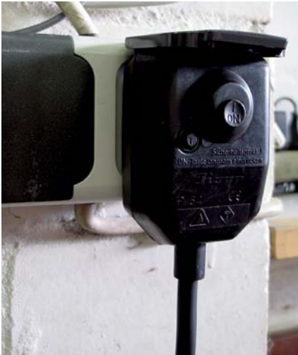
Verwendung eines Personenschutzschalters
