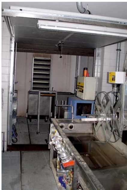
Mittels Tor (im Bild im geöffneten Zustand) kann der Turm von der Schlauchpflege-Straße räumlich getrennt werden – Zugluft wird dadurch vermieden.
