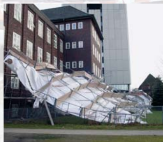
Gerüstumsturz durch Sturmeinwirkung
