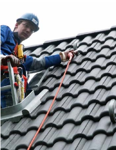
Abb. 5.3.4: Der oberhalb des Dachausstieges liegende Sicherheitsdachhaken kann als Anschlagpunkt genutzt werden.
