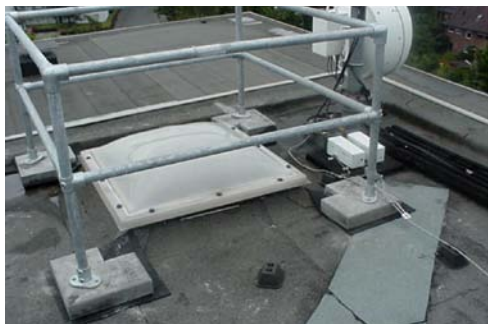
Abb. 7.3.4: Die nicht durchsturzsichere Lichtkuppel im Zugang zum Arbeitsbereich an der Antennenanlage ist durch eine Umweh- rung gegen Absturz gesichert.
