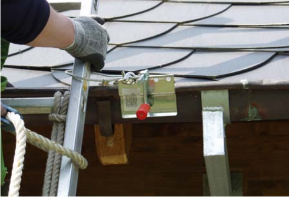
Abb. 4.3.3: Anlegeleiter als Zugangsweg zur Dachfläche: Die Leiter wird gegen seitliches Verrutschen durch eine spezielle Haltevorrichtung gesichert.
