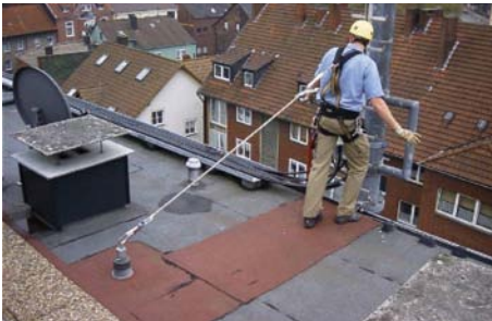
Abb. 7.5.1.1: Durch die Position des Anschlagpunktes in ca. 2,5 m Entfernung von der Dachkante ist auch bei max. Einstelllänge des Verbindungsmittels ein Absturz nicht möglich.
