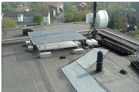
Abb. 7.3.6: Die Lichtkuppel im Arbeitsbereich ist durch einen aufgeständerten Gitterrost gesichert. Mögliche Funktionen der Lichtkuppel sind berücksichtigt.
