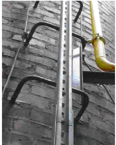
Abb. 4.1.3: Steigeisengang älterer Bauart mit nachgerüsteter Steigschutzschiene als Absturz-sicherung. Eine sichere Besteigung wird durch Einsatz eines mitlaufenden Auffanggerätes in Verbindung mit einem Auffanggurt nach DIN EN 361 ermöglicht. Hinweis: Beidseitig der Führungsschiene sollte die verbleibende Trittbreite auf dem Steig-eisen min. 85 mm betragen.
