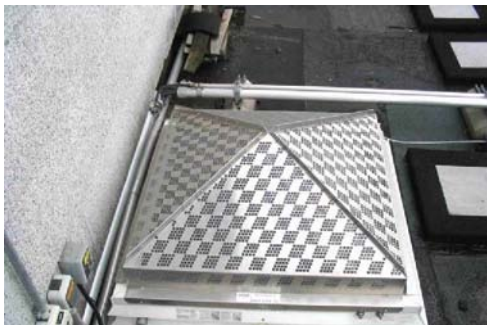
Abb. 7.3.7: Sicherung einer Lichtkuppel mit einer Abdeckhaube aus Aluminium. Die Gestaltung der Lichtöffnungen ermöglicht einen gleichmäßigen diffusen Lichteinfall.
