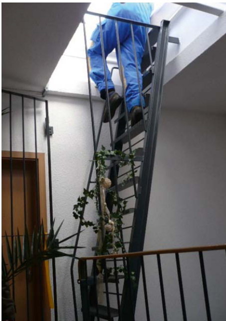
Abb. 4.4.1: Zum Schutz vor einem Absturz von der ortsfesten Stufenleiter ins Treppenhaus verfügt die Leiter über ein seitliches Schutzgitter.
