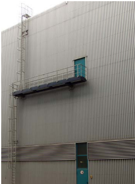
Abb. 4.1.1: Steigleiter mit Rückenschutz und einer Absturzhöhe > 5 m
