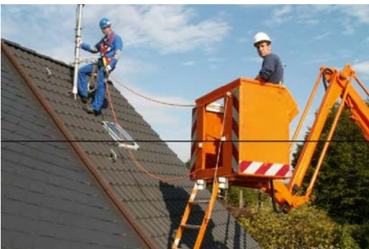
Abb. 4.2.4: Eine Sicherung gegen Absturz an der Hubarbeitsbühne ist möglich, wenn der Arbeitskorb über einen Anschlagpunkt nach DIN EN 795 verfügt.
