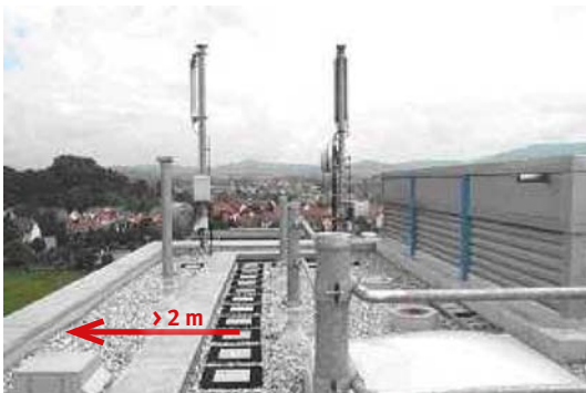
Abb. 6.0.2: Der Verkehrsweg ist auf der bekiesten Dachfläche mit Gehwegplatten trittsicher gestaltet und ist min. 2 m von der Dachkante (links) entfernt.
