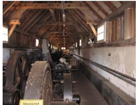
Abb. 6.4.3: Blick in einen Antriebsraum einer älteren Wehranlage. Die Vielzahl der Antriebselemente ist nicht verkleidet. Wartungsarbeiten erfordern freigeschaltete Antriebe.
