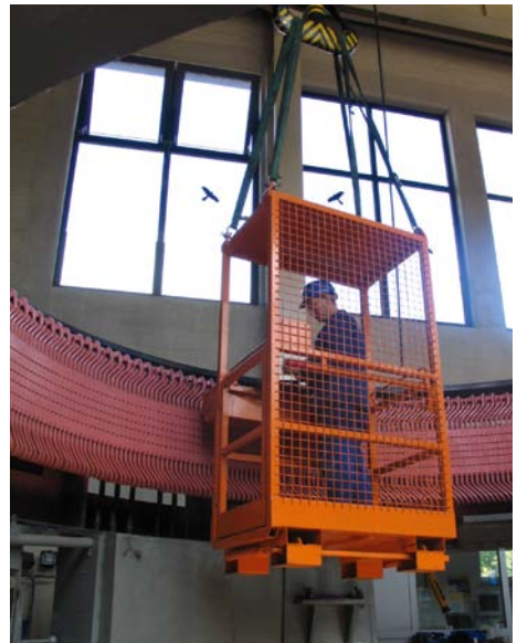
Abb. 6.1.2.3: Personenaufnahmemittel beim Einsatz für Kontrollarbeiten an einer Ständerwicklung eines Generators
