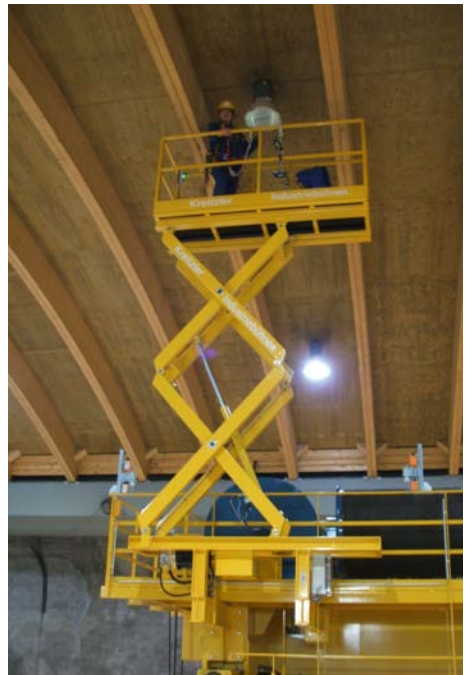
Abb. 4.3.5: Lampenwechsel im Maschinenhaus mit Benutzung einer Scherenhubbühne auf einem Maschinenhauskran.
