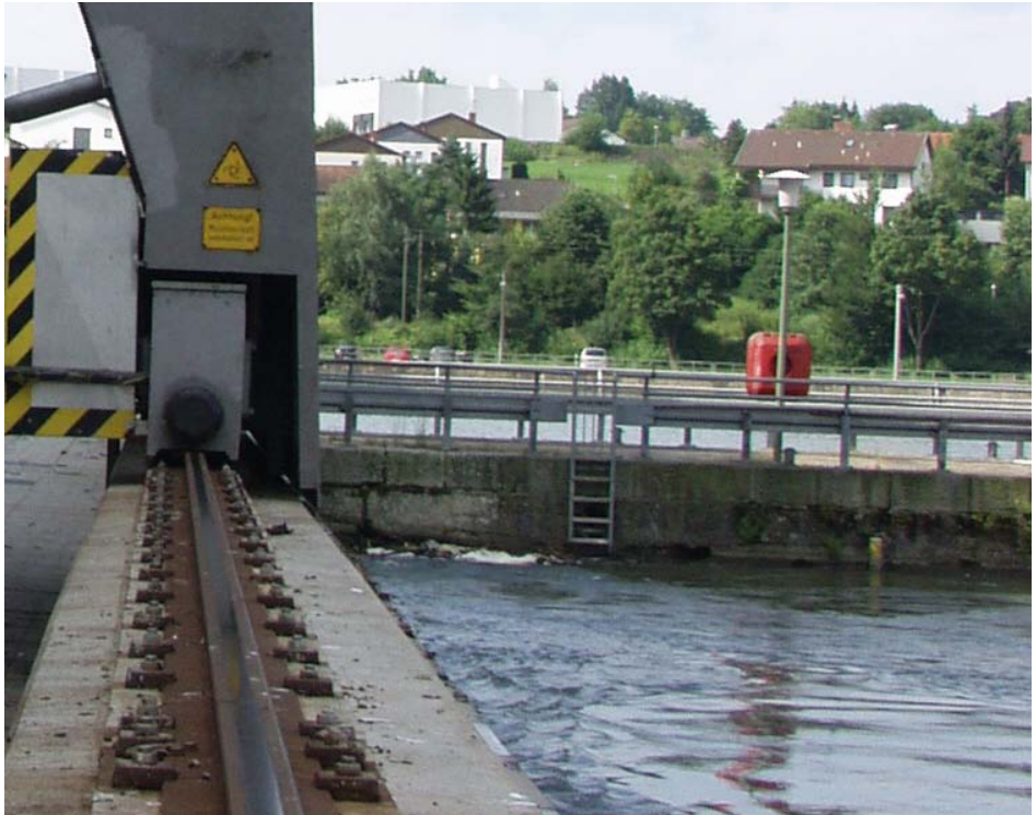
Abb. 5.5: Ausstiegsleiter an einem Oberwasserbecken. In unmittelbarer Nähe befindet sich ein Rettungsring.
