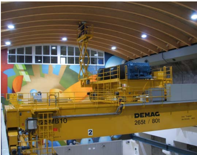
Abb. 6.1.2.1: Die zusätzlich am Brückenkran installierte Scherenhubarbeitsbühne ermöglicht ein einfaches Arbeiten an beliebigen Deckenpunkten. Ein Verfahren des Brückenkrans ist nur bei abgesenkter Bühne möglich.
