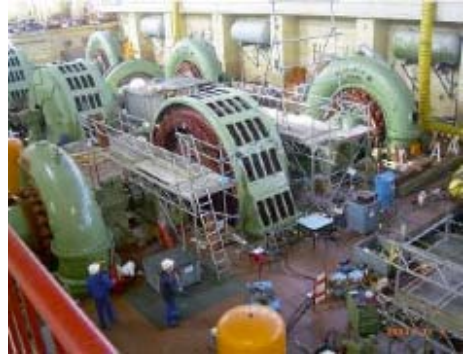
Abb. 4.3.4: Arbeitsbühnen gewährleisten eine sichere Durchführung von Arbeiten an Anlageteilen.
