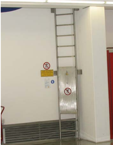
Abb. 4.4.2.1: Steigleiter geringer Bauhöhe ohne Einrichtung zum Schutz gegen Absturz. Die nicht bestimmungsgemäße Benutzung ist durch eine Zutrittsperre verhindert.
