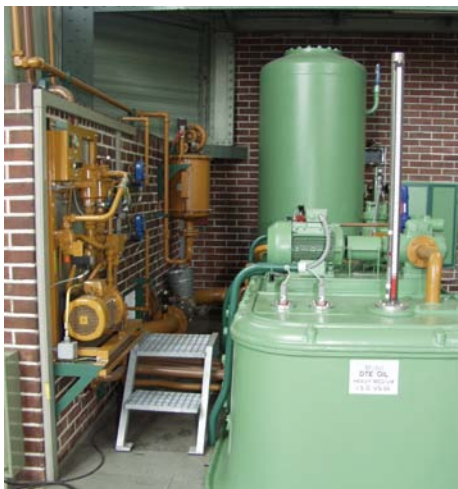
Abb. 4.2.4: Tritt zum Übersteigen von Rohrleitungen. Leider bestehen auch im Bereich von Verkehrswegen immer wieder Sturz- und Stolpergefahren durch verschiedenste Bauteile, z. B. Rohrleitungen. Hier empfiehlt sich der dauerhafte Einsatz von Tritten.
