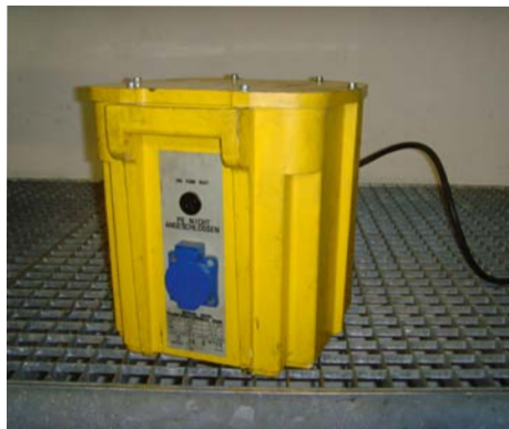
Abb. 7.2: Trenntransformator vor einer Einstiegsöffnung in den Turbinenraum
