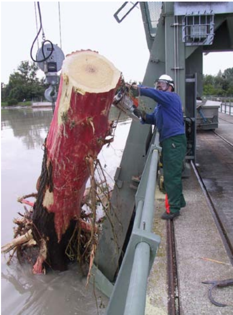
Abb. 6.2.1.3.3: Beispiel für den Einsatz einer Motorkettensäge bei der Beseitigung von Treibgut an einer Rechenreinigungsanlage
