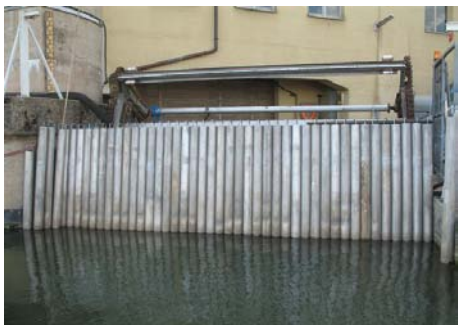
Abb. 6.3.2: Beispiel für eingebaute Verschlussnadeln im Oberwasserbereich eines Kleinkraftwerkes
