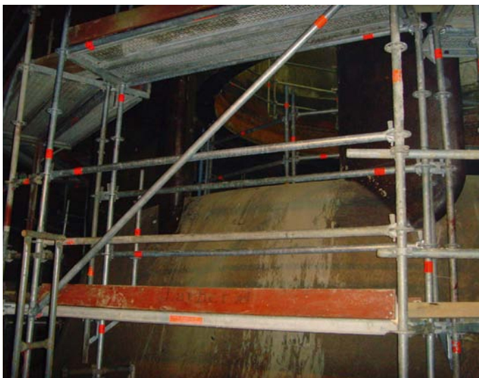
Abb. 6.1.1.10: Beispiel für ein Sondergerüst auf Ebene B gemäß Abb. 6.1.1.7. Ebenfalls verbreitet ist der Einsatz von Hängegerüsten.
