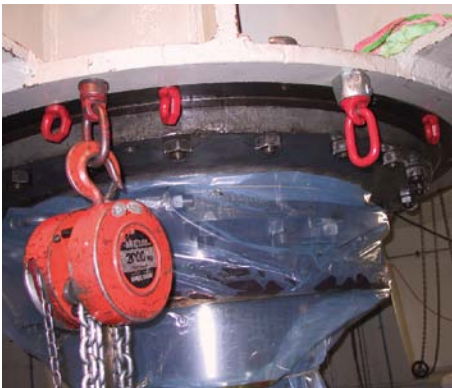
Abb. 6.1.3.1: Temporäre Anschlagpunkte durch den nachträglichen Einbau von Wirbelböcken.
