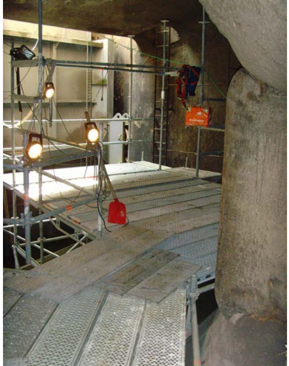
Abb. 6.1.1.11: Sicht von der Turbinenwelle auf eine Sondergerüst in Ebene B gemäß Abb. 6.1.1.7
