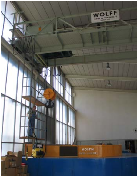
Abb. 6.1.2.2: Sonderkonstruktion zur sicheren Durchführung von Reinigungsarbeiten der Maschinenhausfenster
