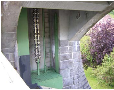
Abb. 6.4.4: Zugangsweg zu einem Wehrklappenkörper. Das Podest kann aufgrund von Schwemmgut bei Hochwasser nicht mit einem Geländer zum Schutz gegen Absturz ausgestattet werden. Die Steigleiter ist mit PSA gegen Absturz zu begehen.
