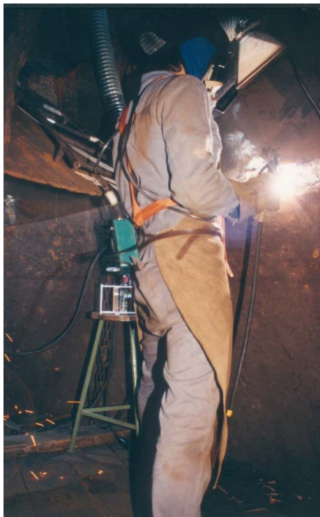
Abb. 7.1: Auftragsschweißen an einem Turbinenmantel. Im Arbeitsbereich liegt erhöhte elektrische Gefährdung vor. Im Rahmen der Arbeiten muss mit einer großflächigen Berührung leitfähiger Teile gerechnet werden.
