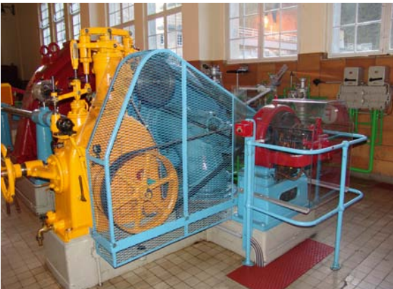
Abb. 6.1.1.3: Einzugstellen an Riementrieben von Regeleinrichtungen werden durch Verkleidungen gesichert.
