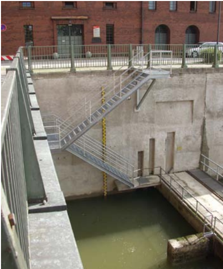
Abb. 4.4.1.1: Beispielhaft ausgeführte Zugangstreppe zu einem Unterwassersteg. Die Treppe wurde als Ersatz für eine früher installierte Steigleiter eingebaut. Der Zugang für unbefugte Personen ist über eine verschließbare Tür gesichert.
