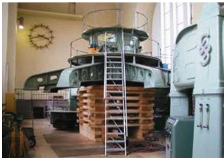
Abb. 4.2.3: Im Rahmen der Revisionsmaßnahme wurde der Tragstern erhöht gelagert, um ausreichende Verkehrswegsbreiten zu erhalten.
