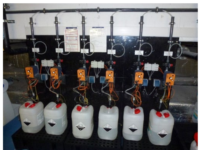
Abb. 10 Dosierstation mit Säure
