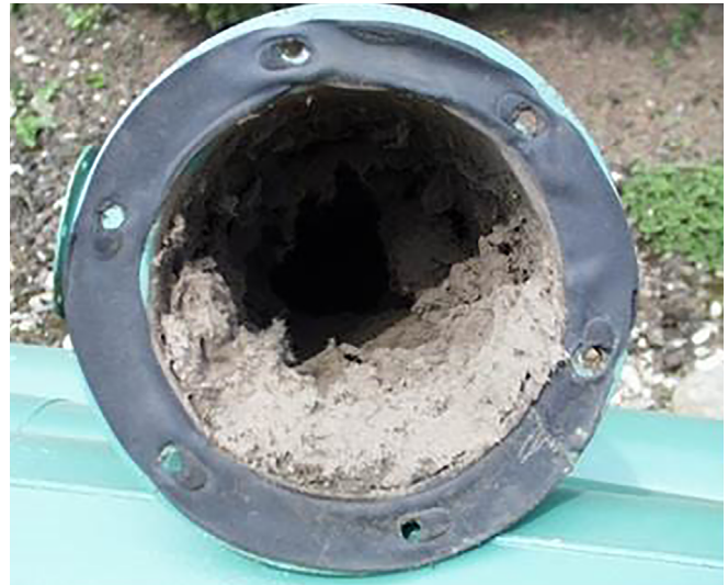
Abb. 9 Starke Ablagerungen in einem Absaugrohr
