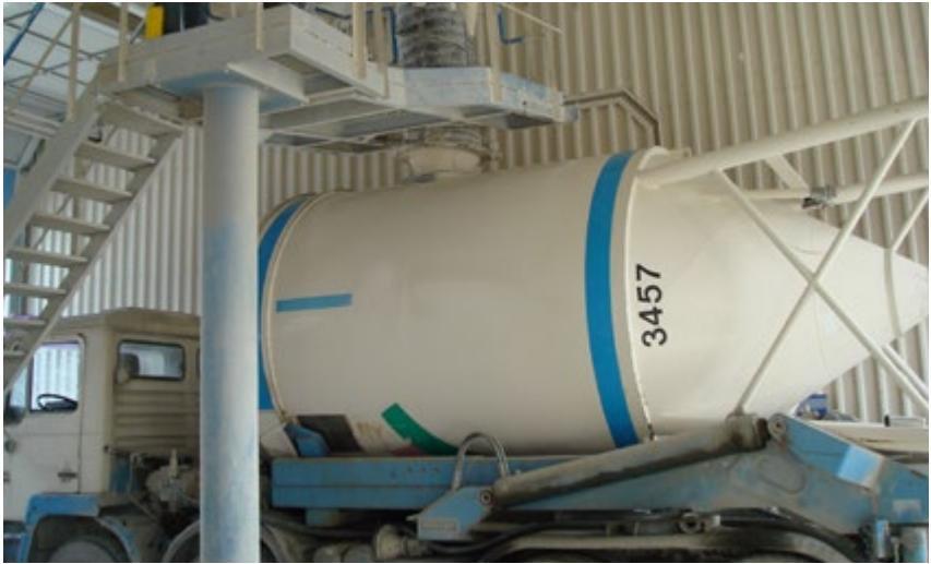
Abb. 1 Ortsfeste Beladestelle transportabler Silos
