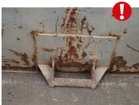
Abb. 17 Aufgeschweißtes Kip- plager entspricht nicht der DIN 30720-1
