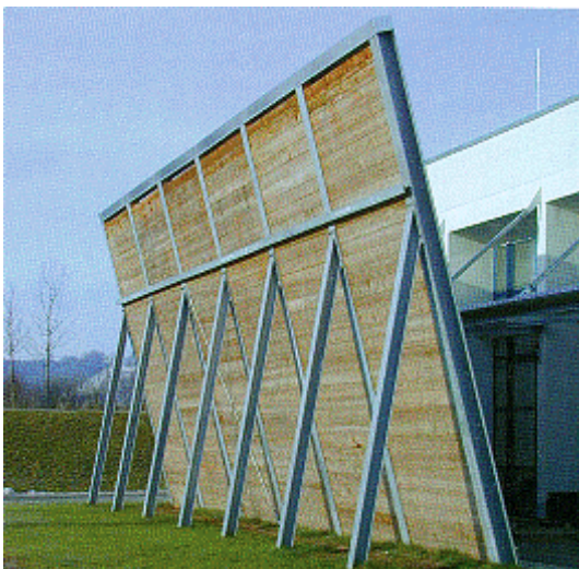
Abb. 12: Gebäude in Ausblasebauart mit wirksamen Splitterschutz
