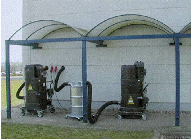
Abb. 17: Ortsfeste Staubsauganlage in der Airbag-Treibratzfertigung
