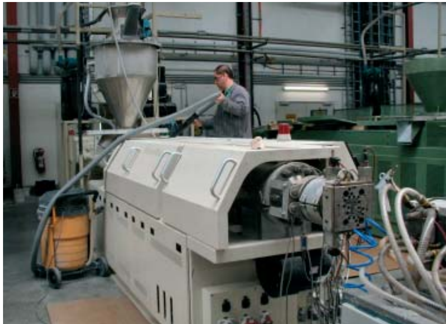
Abbildung 31: Extruder mit trennenden Schutzeinrichtungen für heiße Oberflächen
