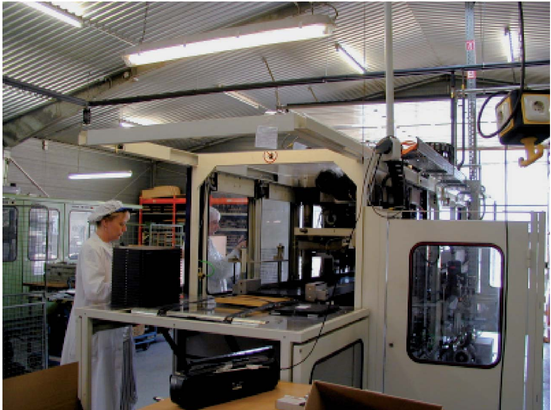
Abbildung 7: Ausreichend gesicherte Austragsöffnung an einer Warmformmaschine (Gefahrstellen lassen sich durch Hineinbeugen nicht erreichen)
