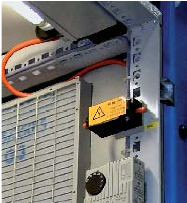
Abbildung 27: Besonders gekennzeichnete Stromkreise, die nicht durch den Hauptschalter vom Netz getrennt werden
