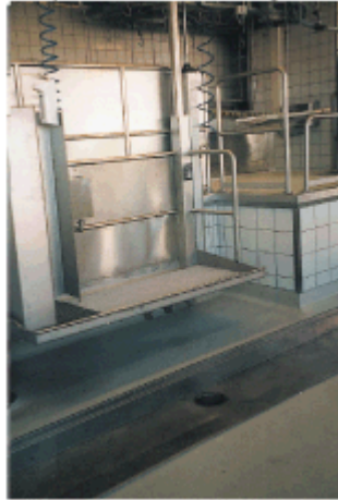
Bild 9: Schlachthubpodest mit Absturzicherungselementen
