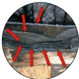
Teerhaltige Dachpappen: PAK
